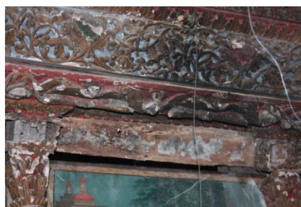
foto 5. Lemn degradat, fracturi, lcune și murdărie aderentă neaderată
