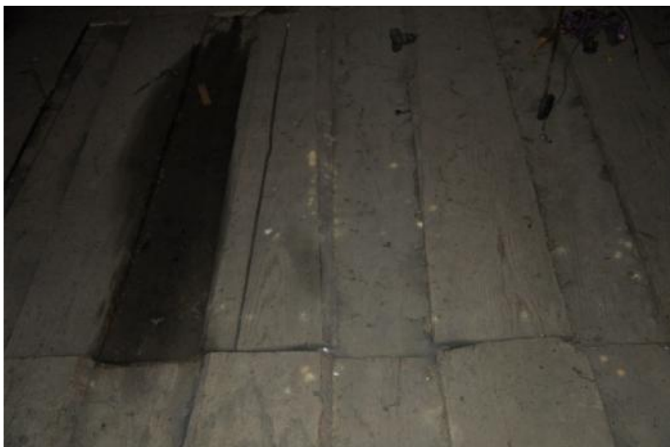
Scânduri ude ceea ce indică faptul că acoperișul permite pătrunderea apei pluviale
