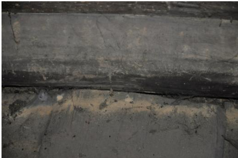
Căprior din componența boltei naosului, cu atac xilofag activ Depuneri de murdărie aderentă și neaderentă, cablu de curent electric fixat direct pe lemn
