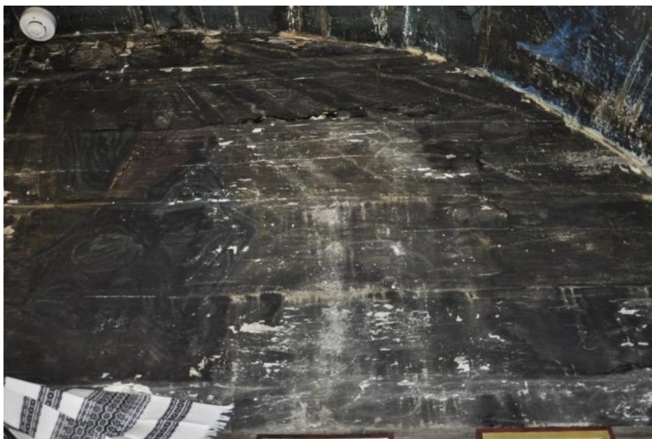
Pierderi ale peliculie de culoare datorate apei care s-a prelinș prin spărturile acoperișului
