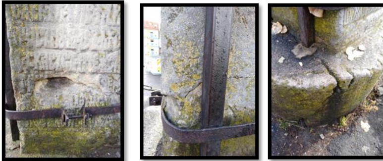
Fig. 6. Infiltrațiile și toate procesele de degradare aferente, au dus la apariția unor suprafețe extinse cu fisuri și degradări ale pietrei.
