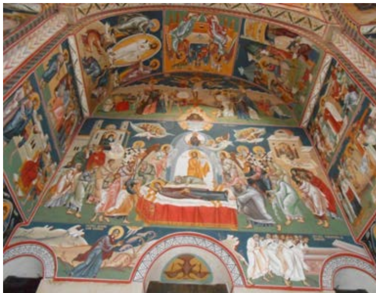
Foto 5. Biserica Mănăstirii Măxineni restaurată. Pictura murală „Adormirea Maicii Domnului”, pe peretele despărțitor deasupra stâlpilor dintre pronaos și naos.
