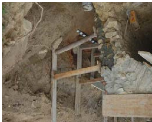
Fig. 16 – cuptorul 1 etapă de lucru
