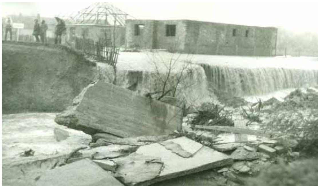
14-16.05.1984 Întorsura Buzăului – pod rupt pe D.N. 10
