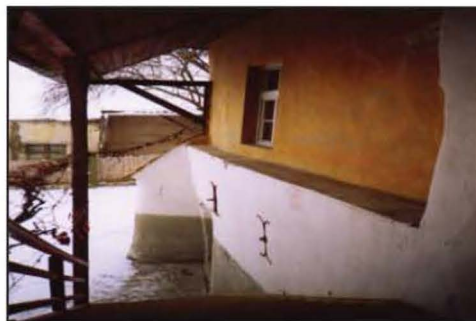
Fig. 3. Peretele pivniței cu tiranți în X și contrafortul de colț.
