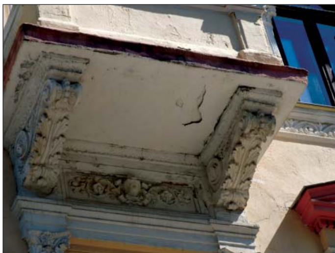
Fig. 11 - datorită materialelor și tehnologiilor neadecvate
