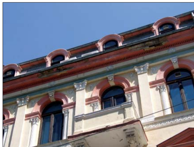
Fig. 10 - ...dar degradările au și apărut,
