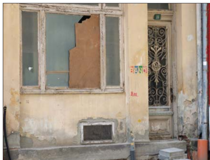
Fig. 14 - Obturarea voluntară a deschiderilor clădirii duce la lipsirea acesteia de ventilația neapărat necesară sănătății sale
