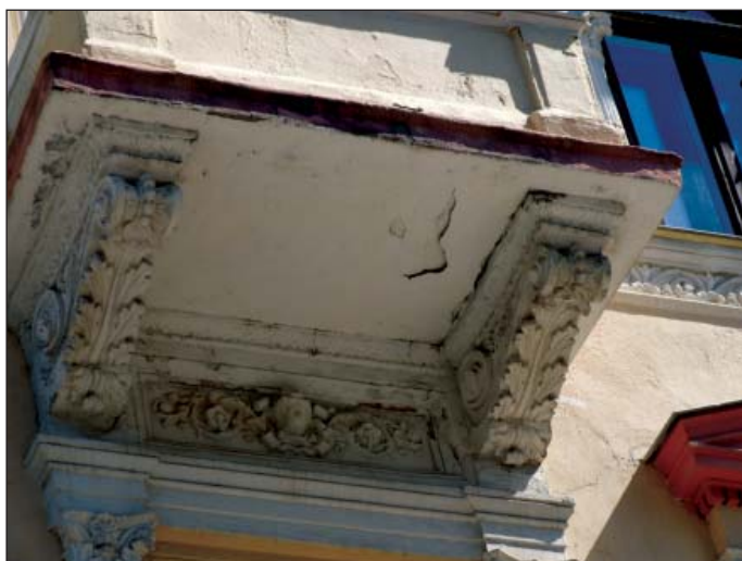
Fig. 11 - datorită materialelor și tehnologiilor neadecvate
