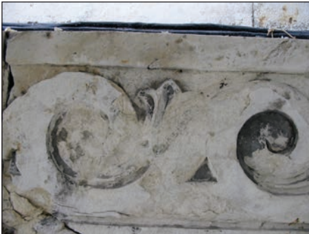
Fig. 4 - Cruste de degradare în nuanțe maronii / cenușii, funcție de poziția molonului în edificiu și de detaliile sculpturale. / Degradation crusts in brown / gray shades, depending on the position of the block in the building and the sculptural details.
