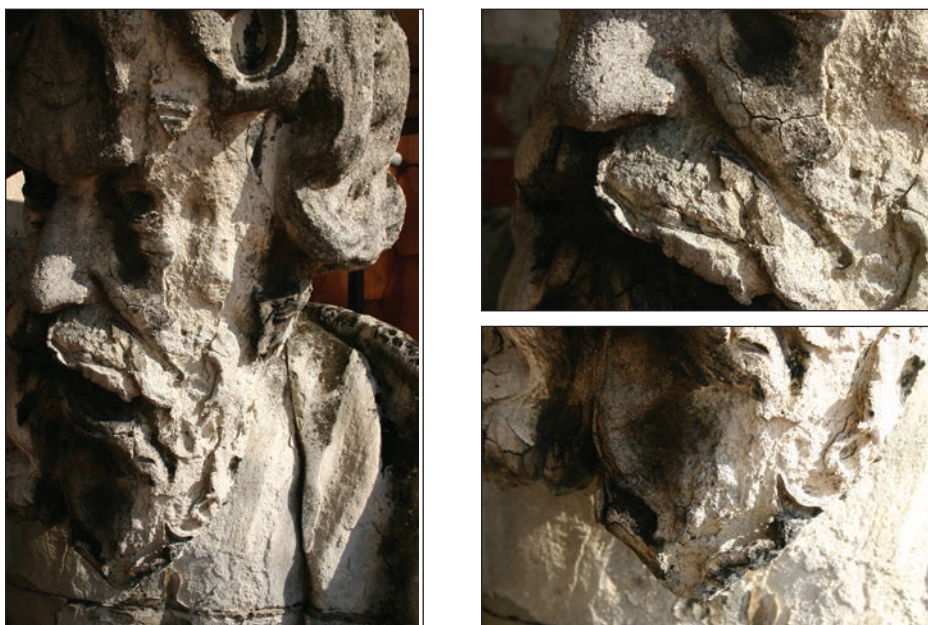
Fig. 14 - Degradare complexă: dizolvare, dezagregare, termofisurare, crustificare și biodegradare. / Complex degradation: dissolution, disintegration, termofisurations, crusting and biodegradation.
