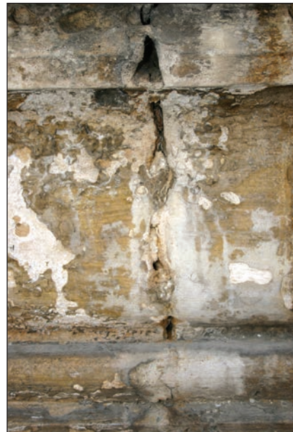
Fig. 13 - Eflorescențele de săruri dezvoltate în zonele de intrados ale moloanelor din zona acoperișului sau la rosturile dintre moloane. / Salts efflorescence developed under the blocks in the roof area or at the joints between the blocks.
