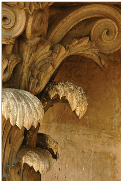
Fig. 9 - Suprafețe de molon slab degradate prin depuneri de praf și excremente de păsări. / Weak degraded areas by dust and bird droppings.
