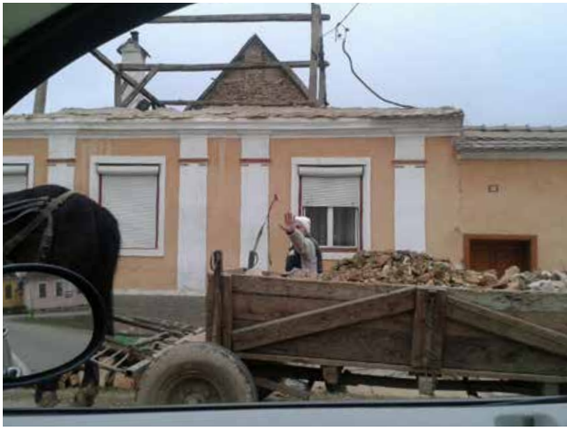
Fig.3 Biertan. Casa din str. Nicolae Bălcescu nr. 28; intervenție neautorizată. (foto martie 2017, arhiva INP)
