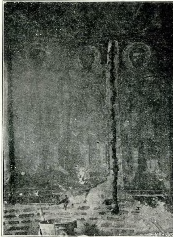
Fig. 12. Crăpătură provenită din cauza lipsei unei legături organice între absida laterală din dreapta și trupul dreptunghiular al bisericii. (Fotografie luată în timpul lucrărilor de restaurare.)
