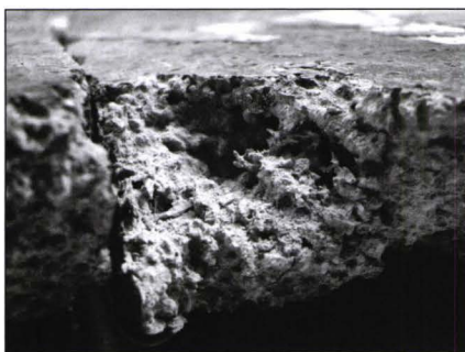
Fig. 7 Detaliu – stratul suport deteriorat de atacul extins al insectelor xilofage
