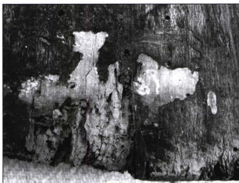
Fig. 6 Detaliu – partea inferioară a icoanei afectată de umiditate și atac biologic. Se pot observa orificiile de zbor, degradarea stratului suport și pierderea totală a stratului de culoare.
