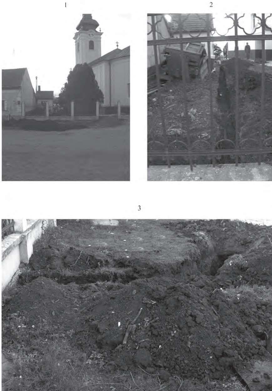
Pl. III. Cefa, biserica ortodoxă, 2008. Excavații pentru conducta de apă a bisericii. 1. Amplasamentul lucrărilor. 2. Excavații în curtea bisericii. 3. Excavații în strada Ungurească.
