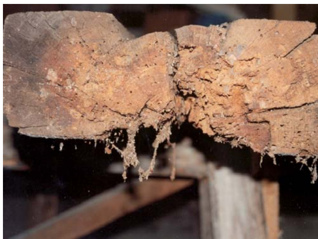
7–8. kép A kapu faragványának állapota restaurálás előtt.
