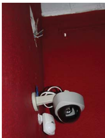
4. kép. Korszerű biztonságtechnikai berendezés.
