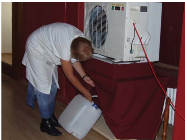
8. kép. A kondenzvíz eltávolítása.
