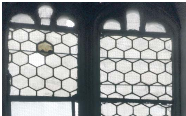
3. kép. Az erősen romlott ablakok szétesését az üveg elé helyezett védőháló késleltetheti.
