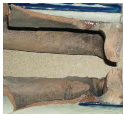
39. kép. Készítéstechnikai hiba, repedés.
