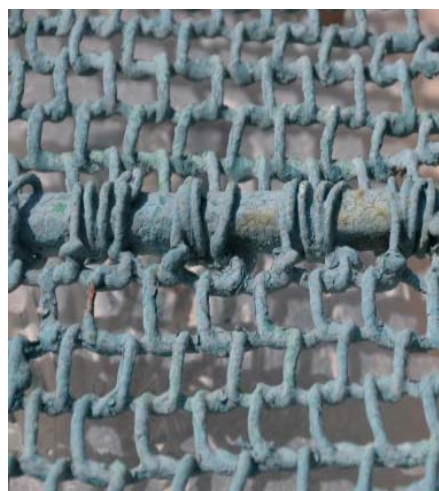
6. kép. Az ablakok védelmét szolgáló rusztikus fémsodrony. Kalocsa, székesegyház.
