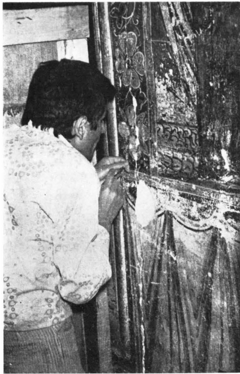
Fig. 29. — L'église de l'ancien monastère Humor (départ. de Suceava); travaux de nettoyage et de consolidation de la peinture de la chambre des tombeaux (1972).
