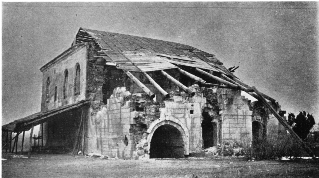
Fig. 16. — La maison de Udriște Năsturel, de Herești (départ. d'Ilfov); avant la restauration.
