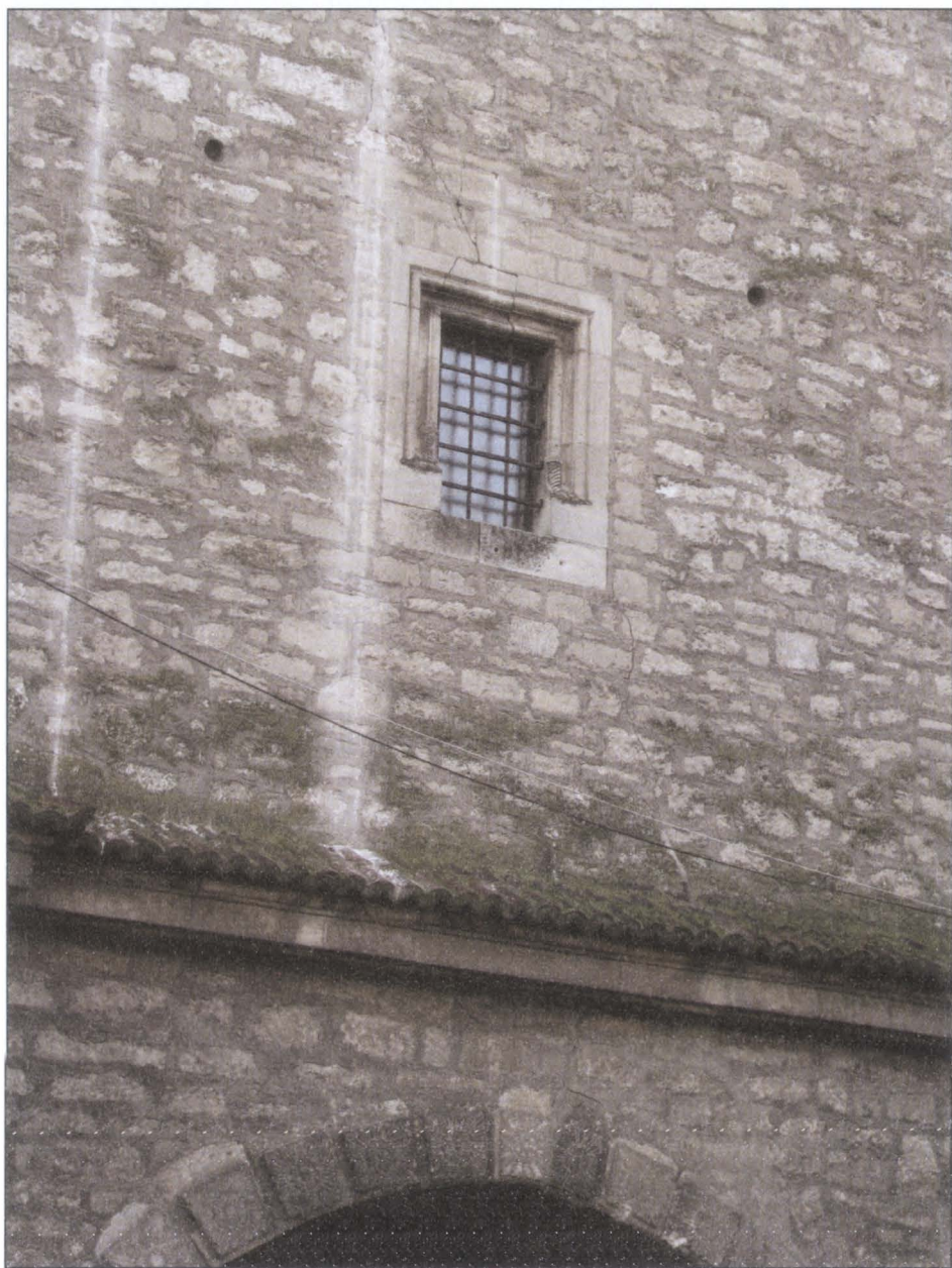
Detalii avarii fațada nord
