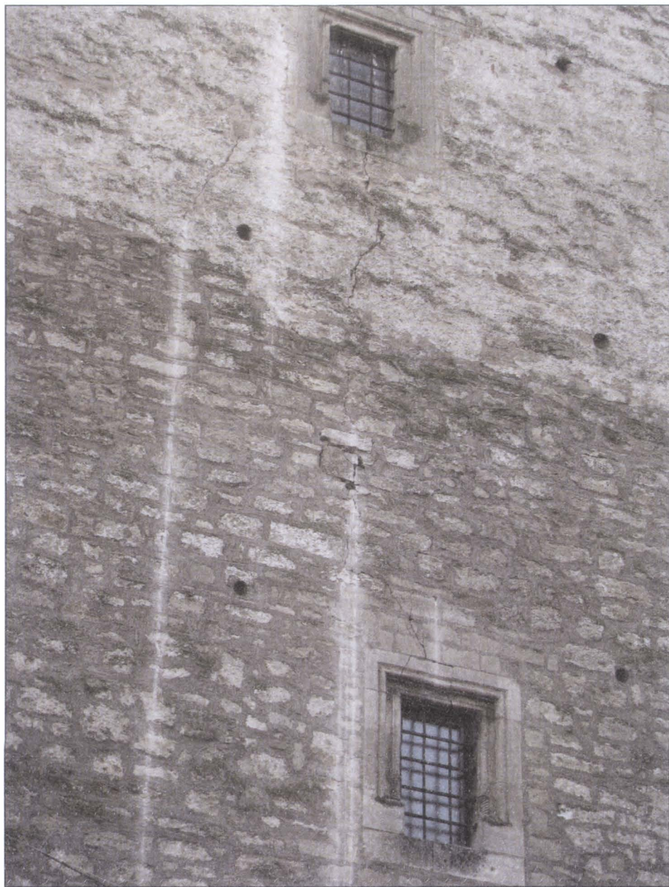
Detalii avarii fațada nord
