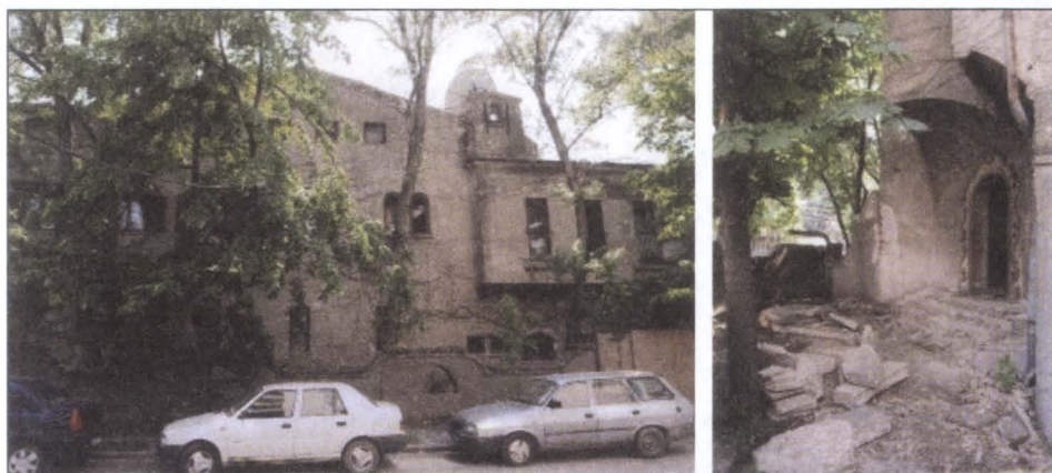
Fig. 7 - Clădirea din Str. Primăverii Nr. 15, expusă autodegradării și vandalizării
