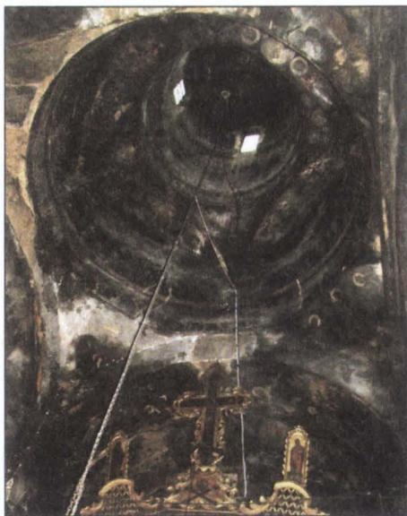
Fig. 6. Turla în 2009; aceeași arie prezentă în ambele imagini cu reparații pe fisuri și lacune cu ciment, repictare a secco , acumulări masive de praf și fum, voaluri și cruste saline provocate de umiditatea care s-a infiltrat prin defectele acoperișului, probabil înainte de 1896 (în imaginea din 1897 de Juan Alpar, forma acoperișului este diferită de cea din 1926).
