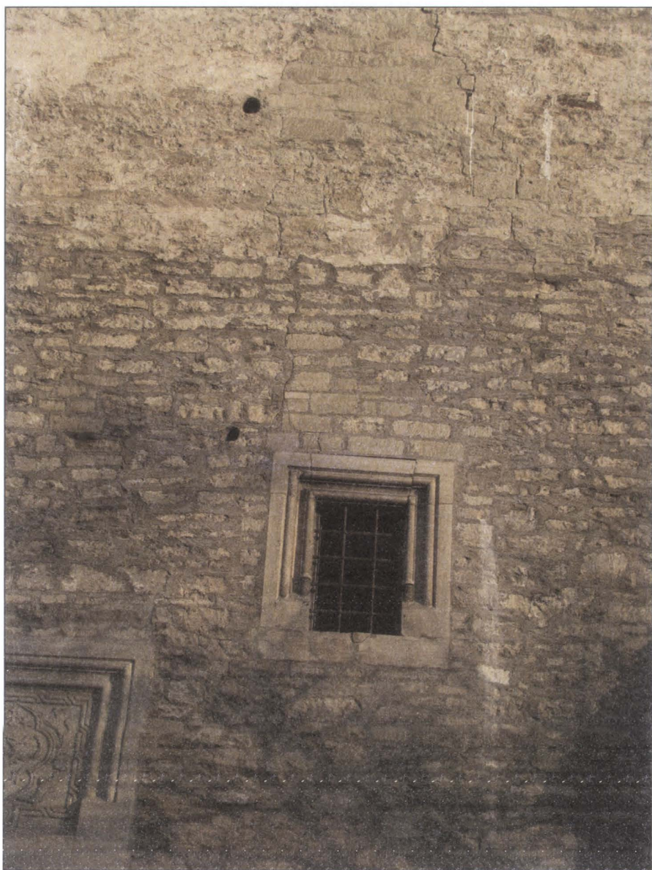
Detaliu avarii fațada sud
