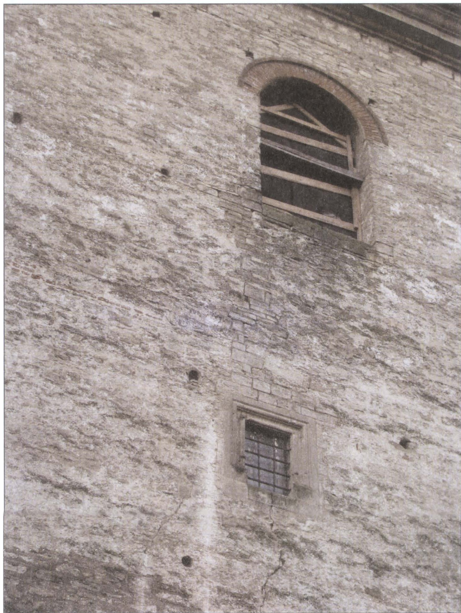
Detalii avarii fațada nord
