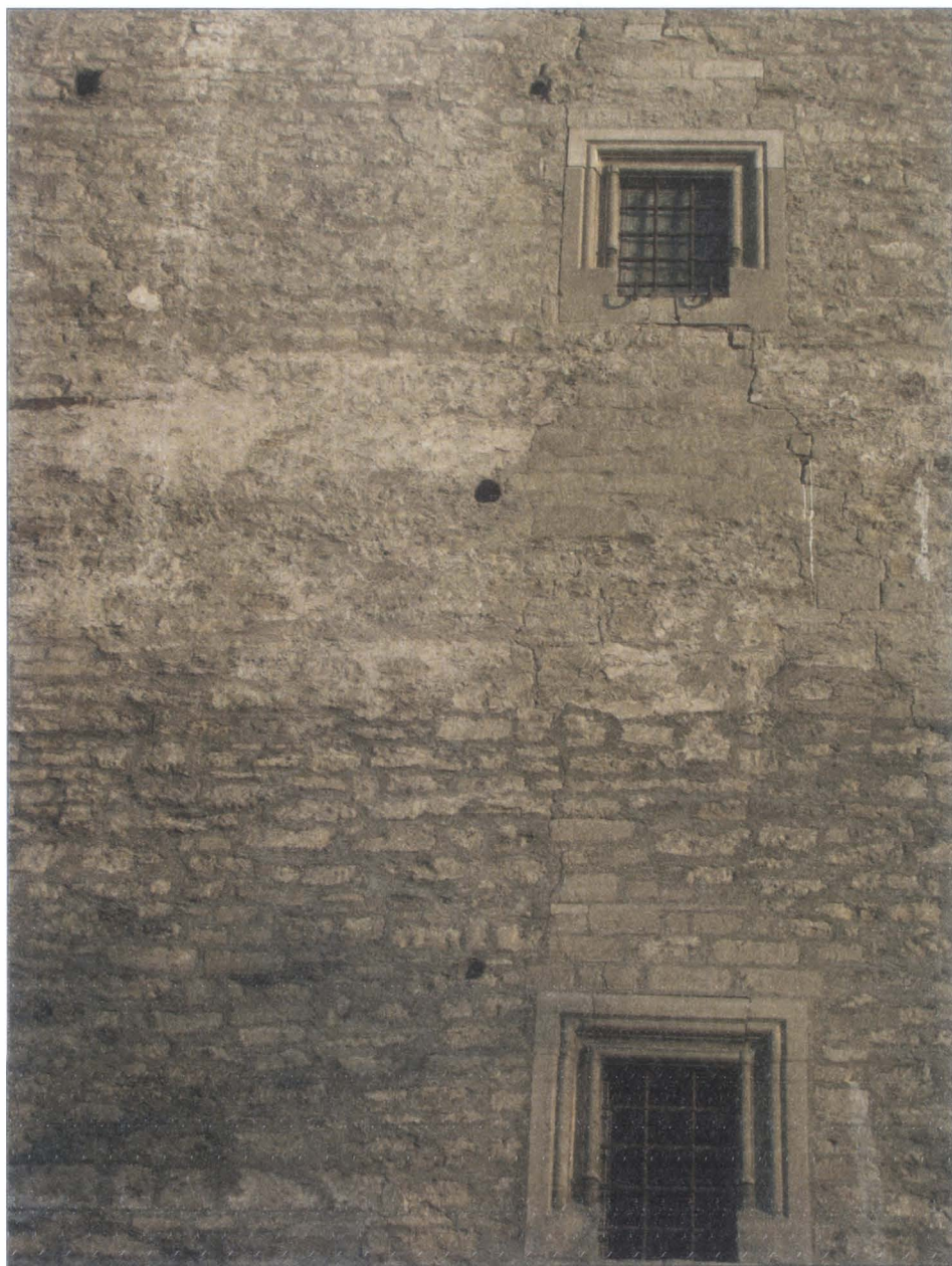
Detaliu avarii fațada sud
