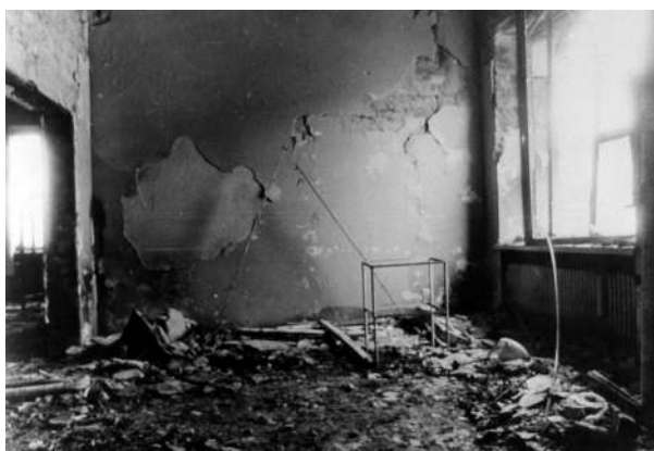
Fig. 3 Laboratorul de Restaurare Pictură de Șevalet (aripa Știrbei) după incendiu (sursă- arhiva M.N.A.R.)
