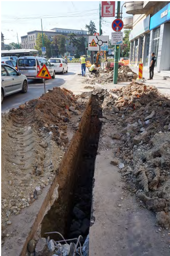
Fig. 11. Șanțul de poziționare a cablurilor cuprins între structura fortificației bastionare din Piața Mărăști și intrarea Facultății de Arte, în care nu au fost identificate structuri ale fortificației bastionare.
