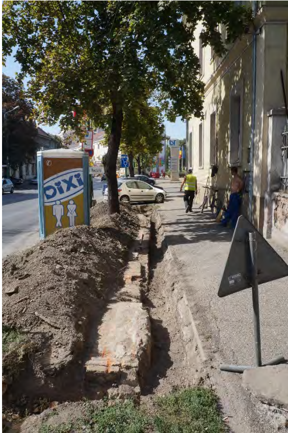
Fig. 16. Șanțul de poziționare a cablurilor cuprins între Căminul nr. 7 și nr. 8 de pe strada Oituz, unde au fost identificate structuri zidite (vedere dinspre est).
