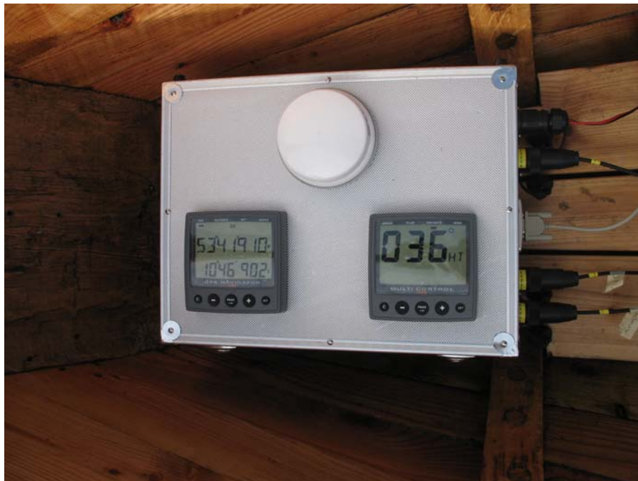
Abb. 13: Instrumentenkoffer mit NX2-Server, außen GPS und Kontrollanzeigen
