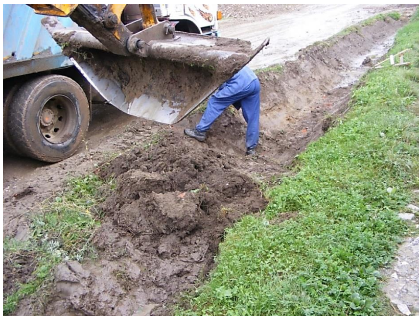
Fig. 10. Imagine cu rigola suprapunând pe traiectul său vechea conductă de gaz (1) și rigola săpată în punctul terminus al lucrărilor (vizavi de stația de autobuz) (2)
