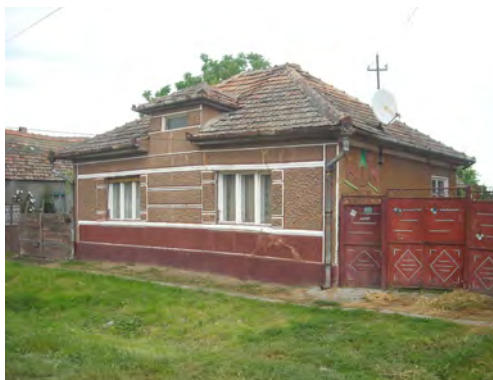
Fig. 25. Casa nr. 117 – paralelă cu axa uliței, tindă, două camere și coridor închis; acoperiș în 4 ape; zidăria de cărămidă, acoperită cu tencuială; decorațiune cu cerbi pe peretele lateral; fundația precară a generat fisuri în pereți (ulița principală)
