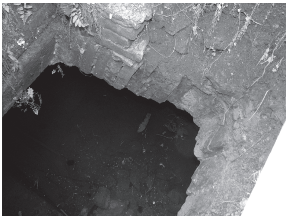
Fig. 74. Strâmbu Băiuț. Rezervor de apă de pe teritoriul topitoriei (foto C. Kacsó).
