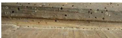
47. Detaliu traversă înainte de restaurare
