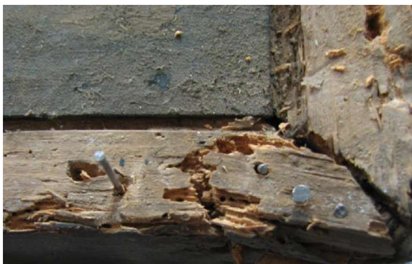
Fragilizări ale îmbinărilor ramei
