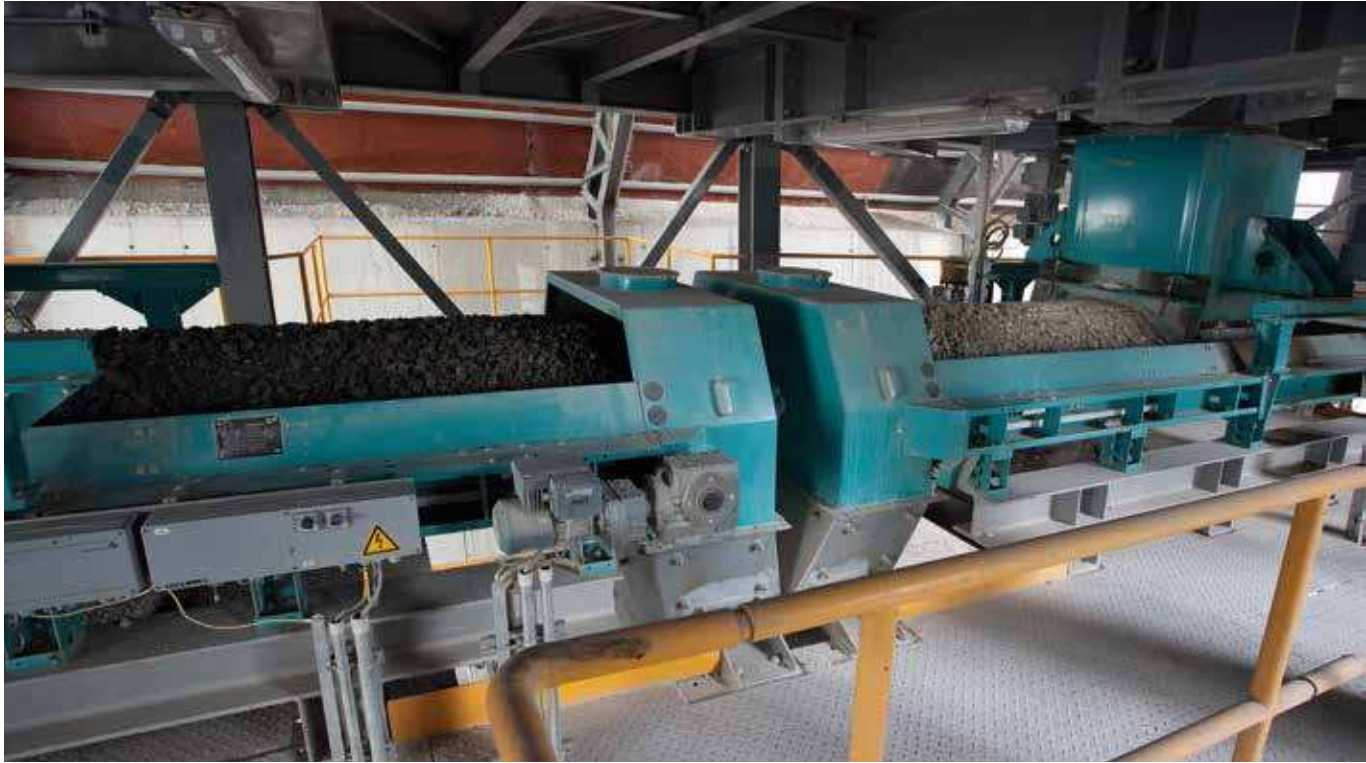
Dozatoare gips și calcar - moara de ciment nr. 4 CEMTEC
