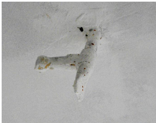
Foto 11 / Снимка № 11 / Photo no. 11 Urma instalației de iluminat cu gaz aerian Останки от инсталацията за осветление с газ Trace of the gas lighting installation
