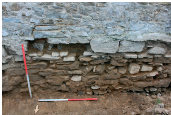
Fig. 3. Secțiunea S6, deteriorări ale fundației.
