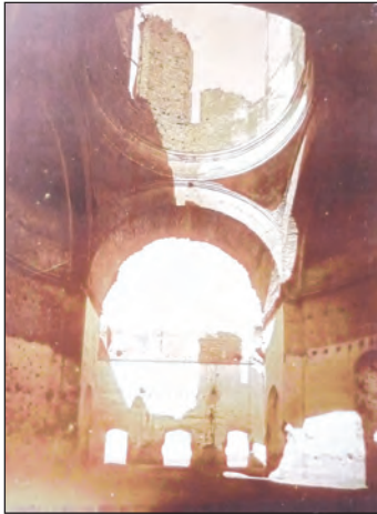
Fig. 11. Ruina bisericii Mănăstirii Giulești. Vedere interioară din naos către pronaos cca. 1900, Fond CMI, No 20/474, Fototeca INP
