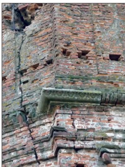
Fig. 24. Ruina bisericii Mănăstirii Giulești: fațada Est; detaliu, lastra de colț. Foto arh. D. D. Ionescu 2010
