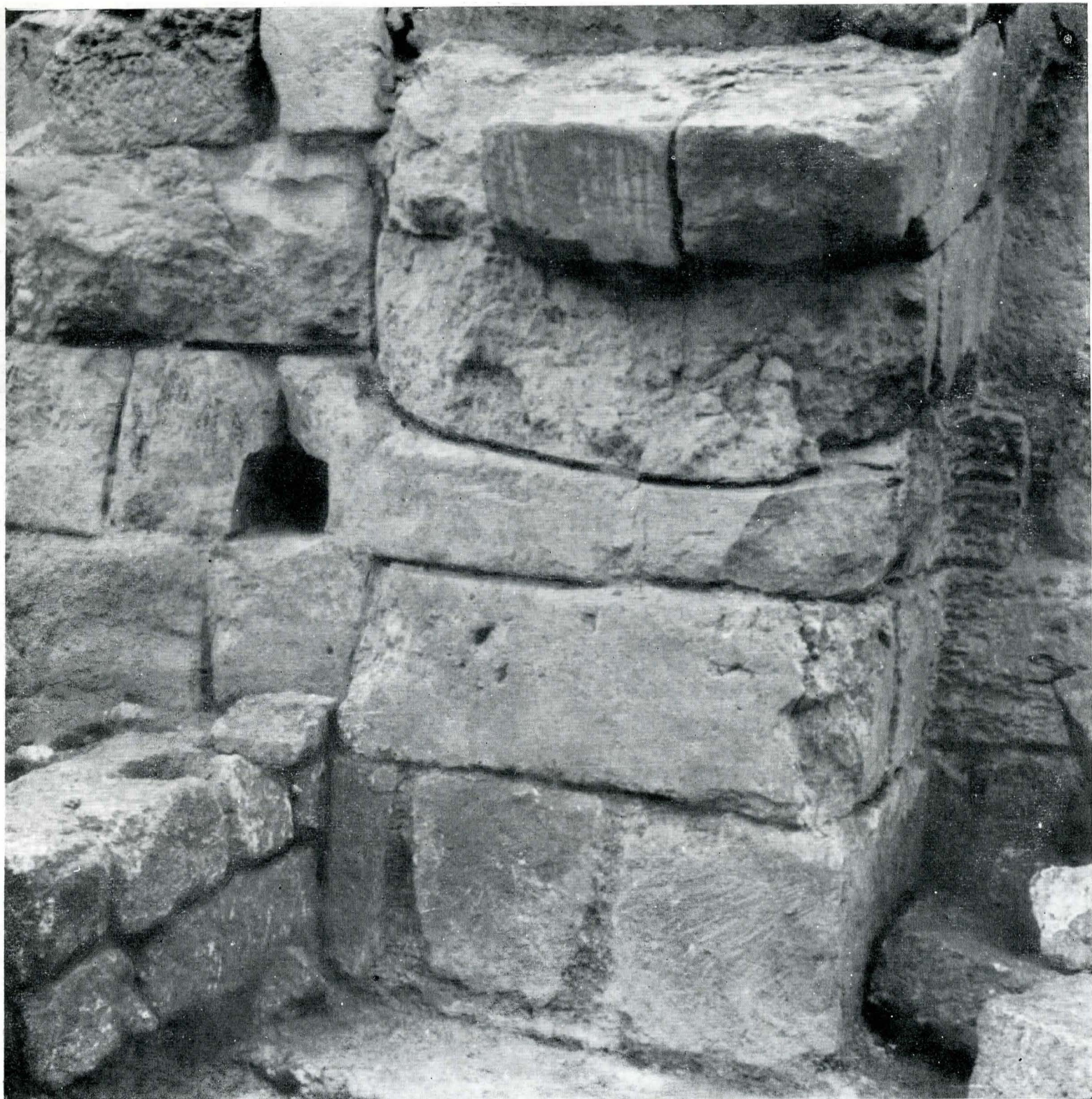
Fig. 5. Pintenul sting al porții; se distinge una din nișele în care era introdusă bara de blocare a batanților.
