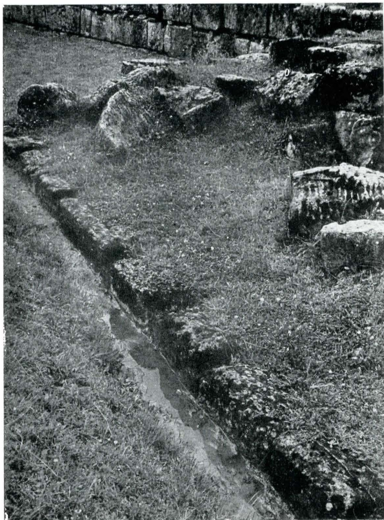
Fig. 7. Cetatea Costești; apa stagnează la baza blocurilor.
