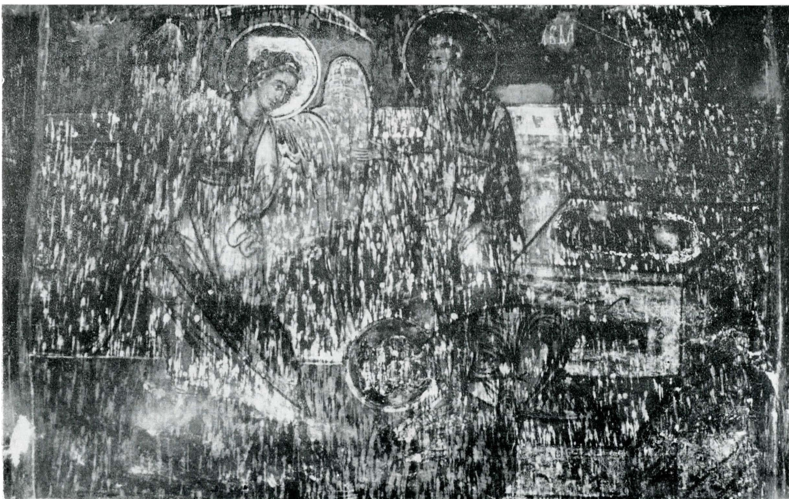
Fig. 1. Gropnița — perete de nord: „Falsa tăiere a capului lui David“. Eflorescențe produse datorită picăturilor de condens.
