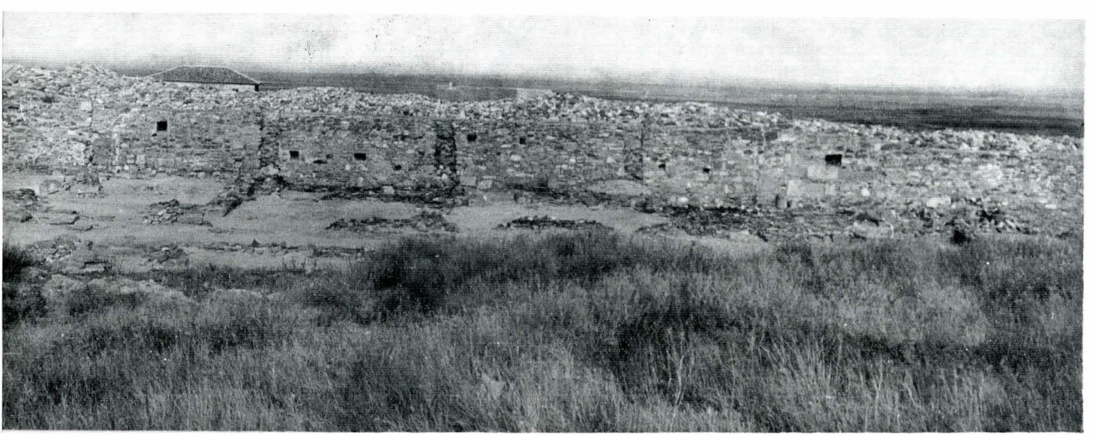
Fig. 2. Zidul de incintă târziu în care se pot distinge golurile pentru evacuarea apei.
