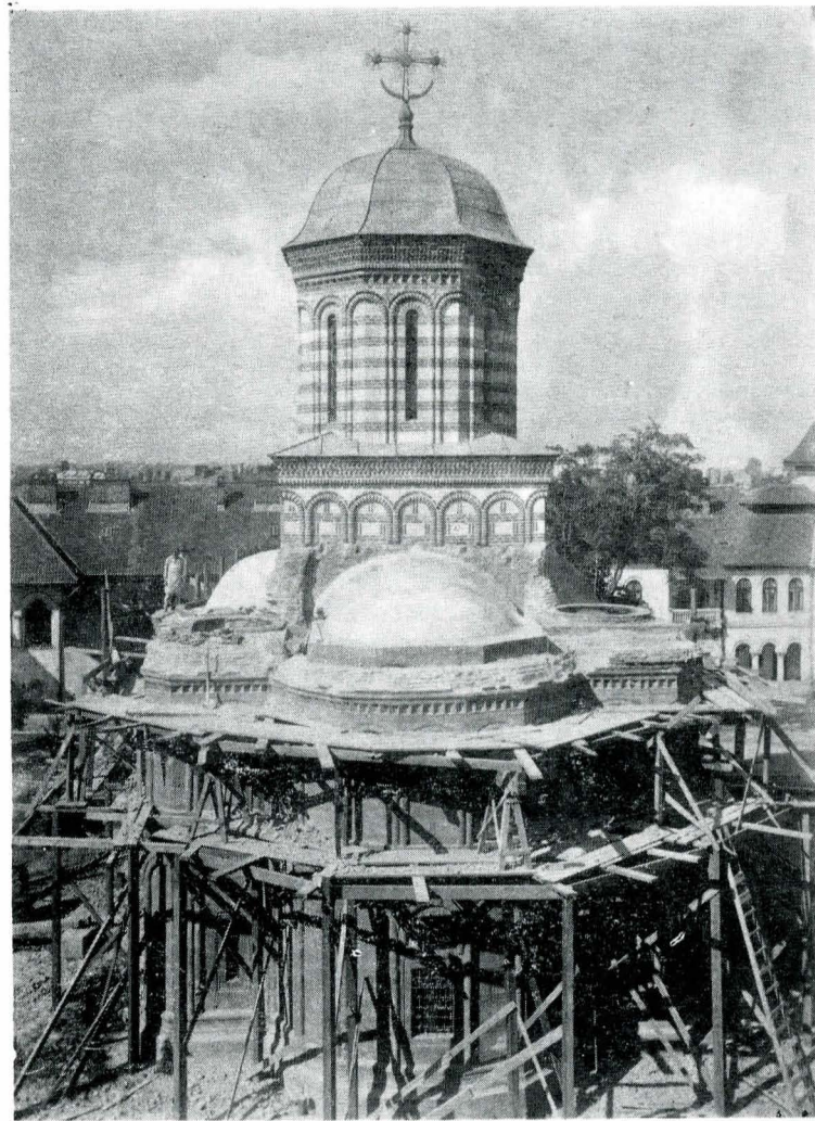
Fig. 1 Biserica Mihai Vodă din București, restaurată de C.M.I. între 1928—1935, arh. Em. Costescu. Vedere dinspre est în 1931. Este terminată refacerea în zidărie a turlei pantocratorului. În curs de execuție, cornișa generală și bazele celor două turle ale pastorațiilor. Foto N. Țațu, clișeu C.M.I., fototeca D.M.I.
