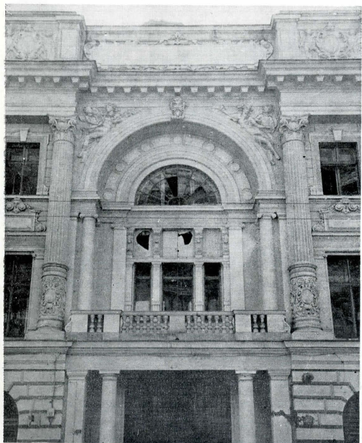
6. Imagine înfălișind una dintre cele două intrări principale în holul central, înainte de restaurare.
