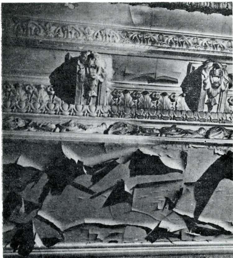
Camera 20. Vestibul (perete est), imaginea cu lumină razantă ilustrează desprinderi masive ale straturilor de vopsitorii.
