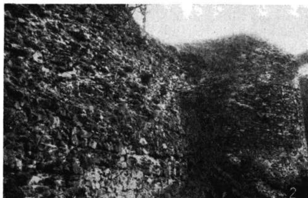
Fig. 9. — 1, deschidere pentru tragere în turnul din centrul laturii sudice; 2, zidul de incintă și turnul de sud-est.
