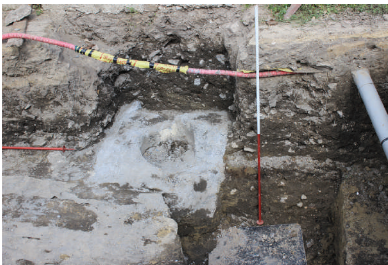
Fig. 11. Nufăru. Str. Ulmului, 2017. Tronson din curțina bizantină de nord, cu intervenția neautorizată din anul 2015 pentru reamplasarea stălpului electric. Vedere dinspre vest, după îndepărtarea părții de fundație modernă de deasupra zidului de incintă.
