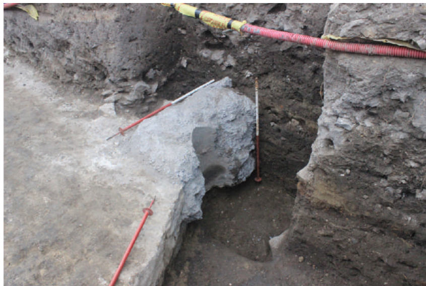
Fig. 12. Nufăru. Str. Ulmului, 2017. Tronson din curțina bizantină de nord, cu intervenția neautorizată din anul 2015 pentru reamplasarea stălpului electric. Vedere dinspre sud-vest, după îndepărtarea părții de fundație modernă de la sud de paramentul zidului de incintă.
