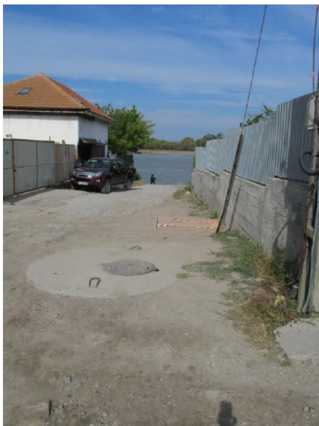
Fig. 18. Nufăru. Str. Ulmului, 2017. Tronson din cortina bizantină de nord. Situația actuală în zona intervenției.
