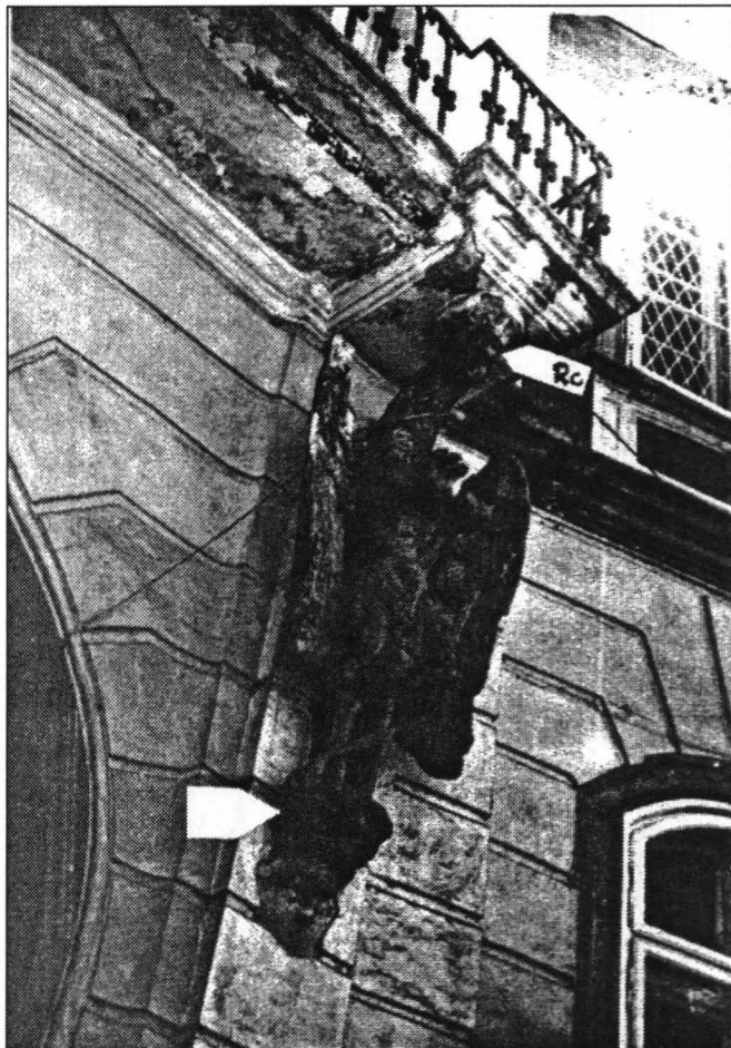
Figura 12. Deteriorarea grifonului de sub balconul care încadrează intrarea în curtea din latura estică.
