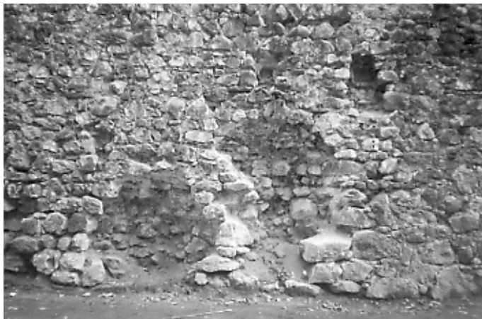
Zidul de incintă al oraşului, vandalizat
