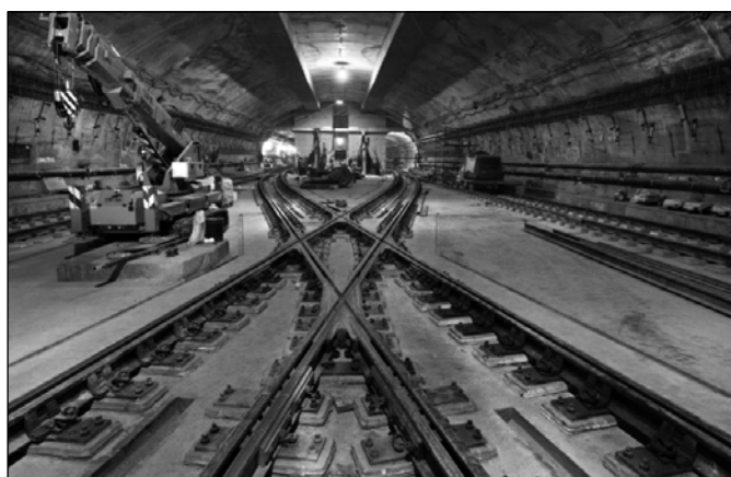
Aspect de la lucrările efectuate de MTA Capital Construction la extinderea rețelei de metrou din New York
